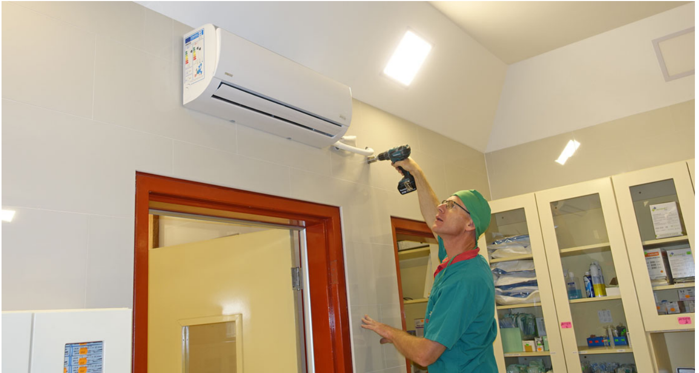
Die neue Klimaanlage im Augen-OP
